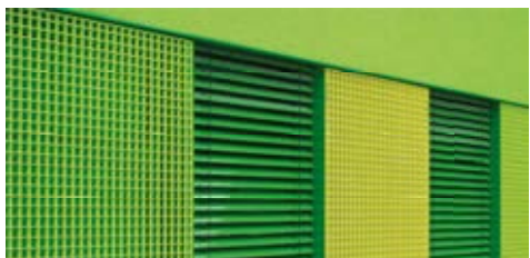
Unten links: Freiherr-vom-Stein-Gymnasium, Münster Unterschiedliche Gitterrostausbildungen als Pressroste inklusive Duplexbeschichtung. Architektonisches Spiel mit unterschiedlichen Rosttypen.
